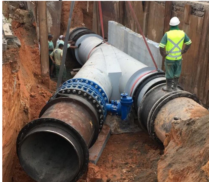
Figura 3- Adutora de um SAA
