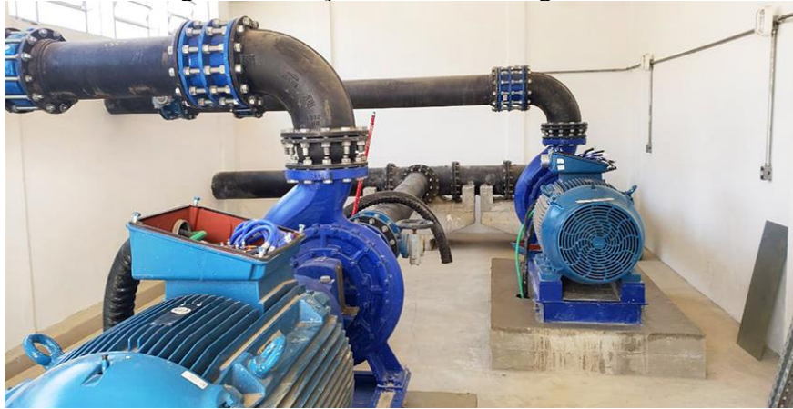
Figura 2- Estação elevatória de água bruta
