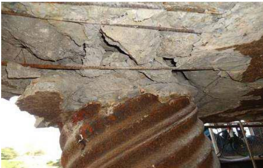
Figura 6: Detalhe ligação bloco-estaca após acidente
