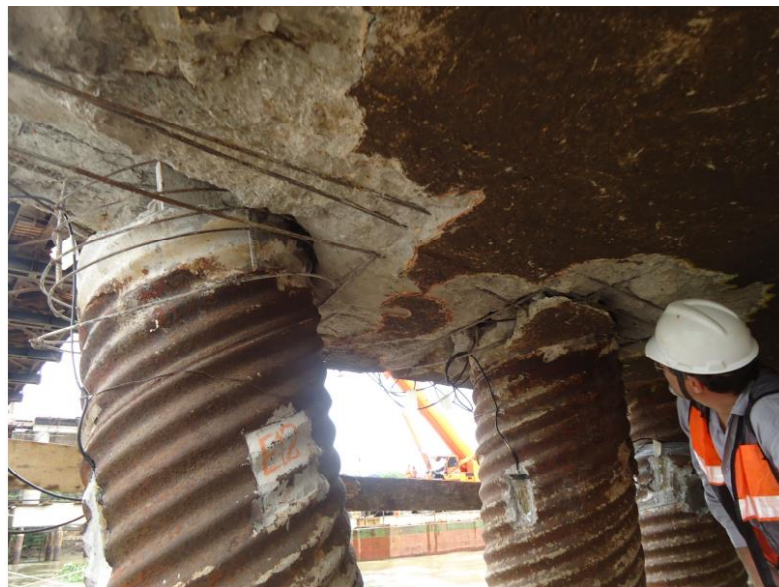
Figura 24: Estacas E-12 e E-13 após o acidente
