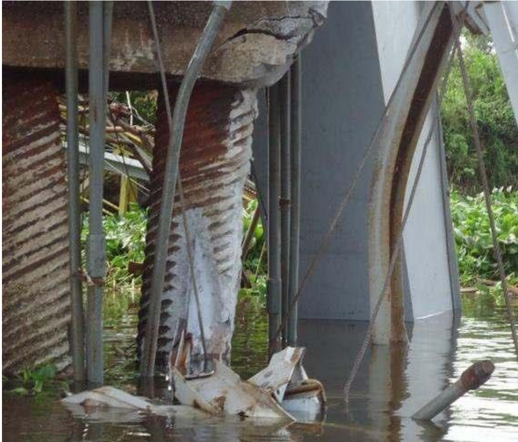
Figura 5: canto do bloco B6 e estaca E-12 danificados
