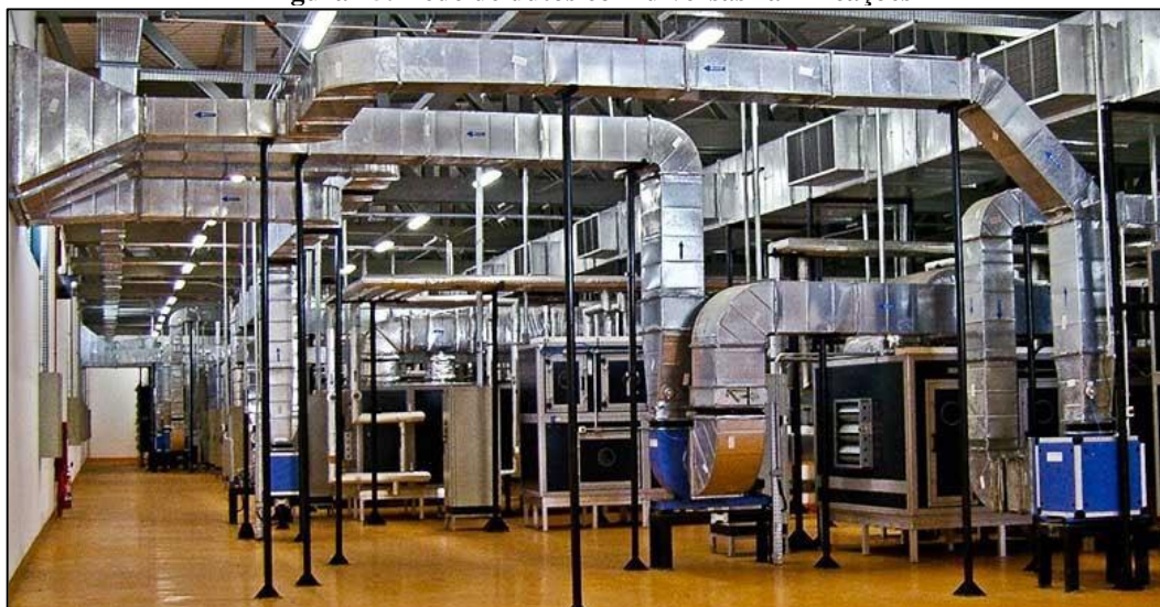
Figura 15. Rede de dutos com diversas ramificações
