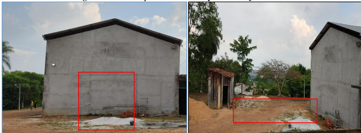
Figura 40. Localização da casa de máquinas da self contained
