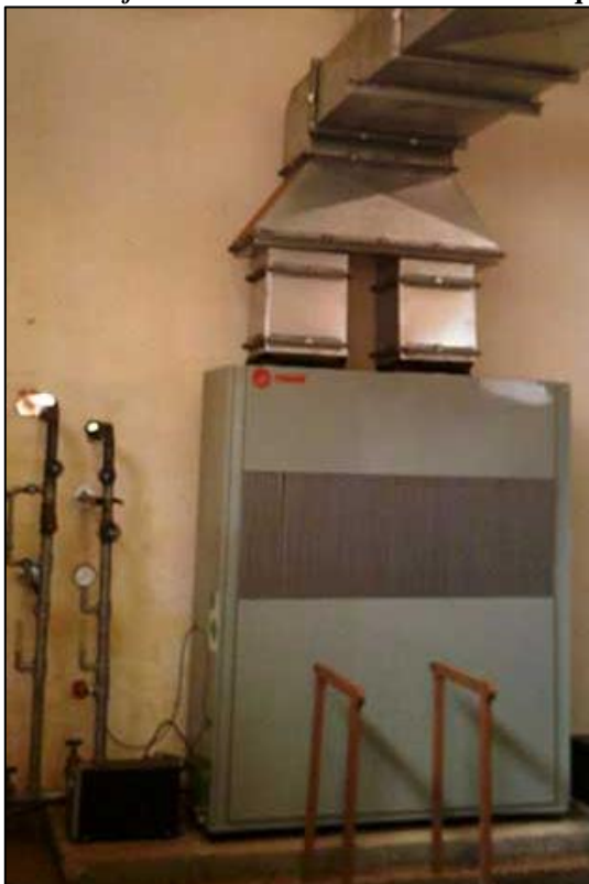
Figura 41. Self contained instalada na casa de máquinas
