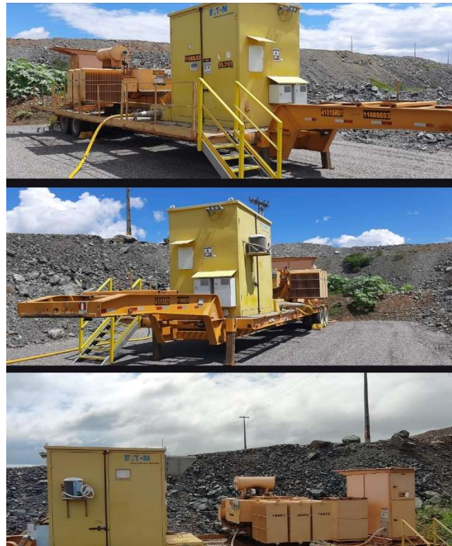
Figura 13 – SE móvel 13.8 kV.
