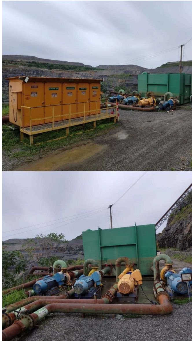
Figura 14 – Painéis e motores 4.160 kV.
