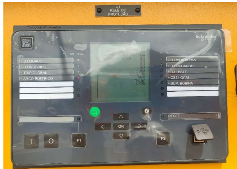
Figura 45 - Relé PowerLogic P3F30.
