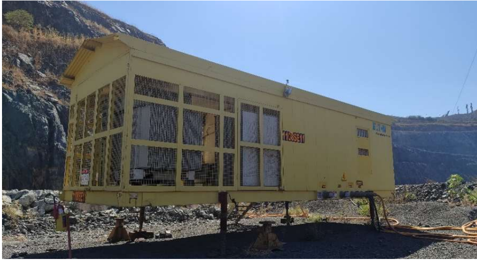
Figura 16 - Subestação abaixadora de 13.8 kV para 4.16 kV.
