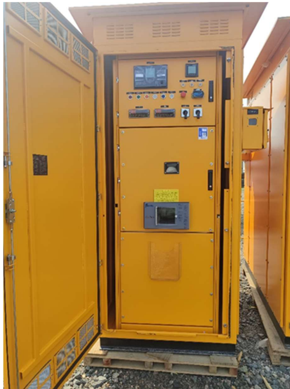
Figura 44 – QD de 13.8 kV da Sempel Painéis Elétricos.
