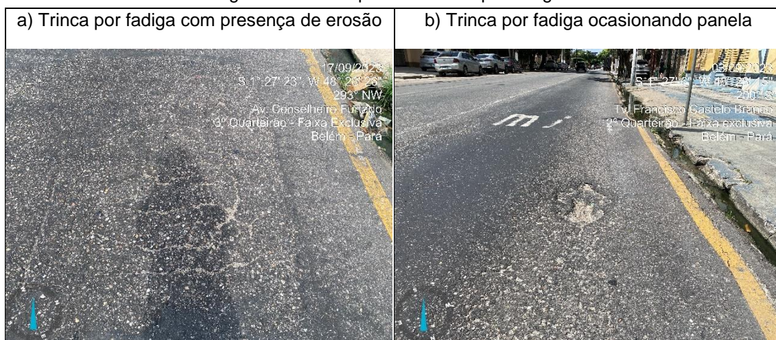
Figura 24 – Exemplos de trincas por fadiga
