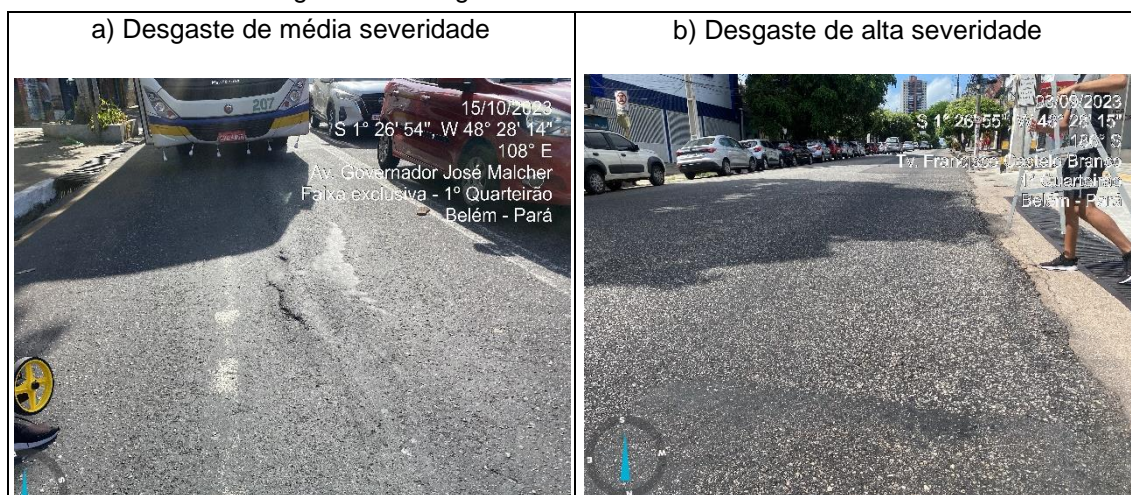
Figura 22 - Desgastes de média e alta severidade
