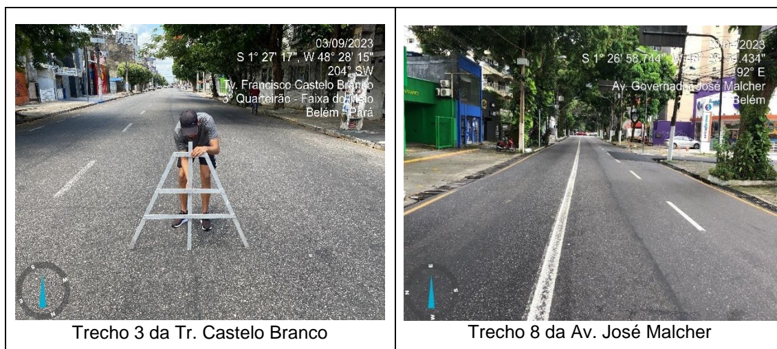
Figura 21 - Defeitos encontrados nos trechos menos críticos
