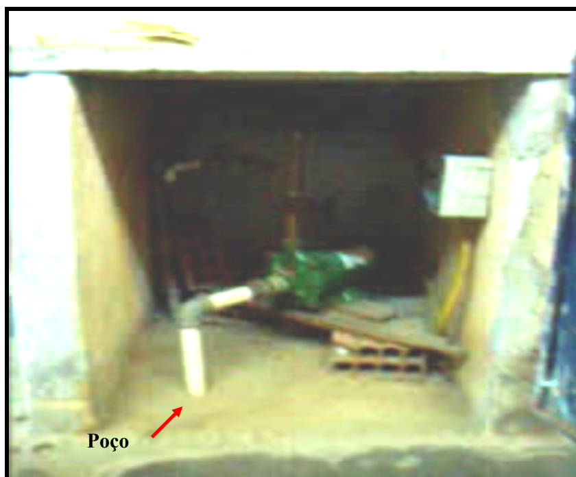
Foto 03 – Poço tubular mediano profundo localizado no bairro Barra do Ceará, Fortaleza/CE. (Novembro/2007)
