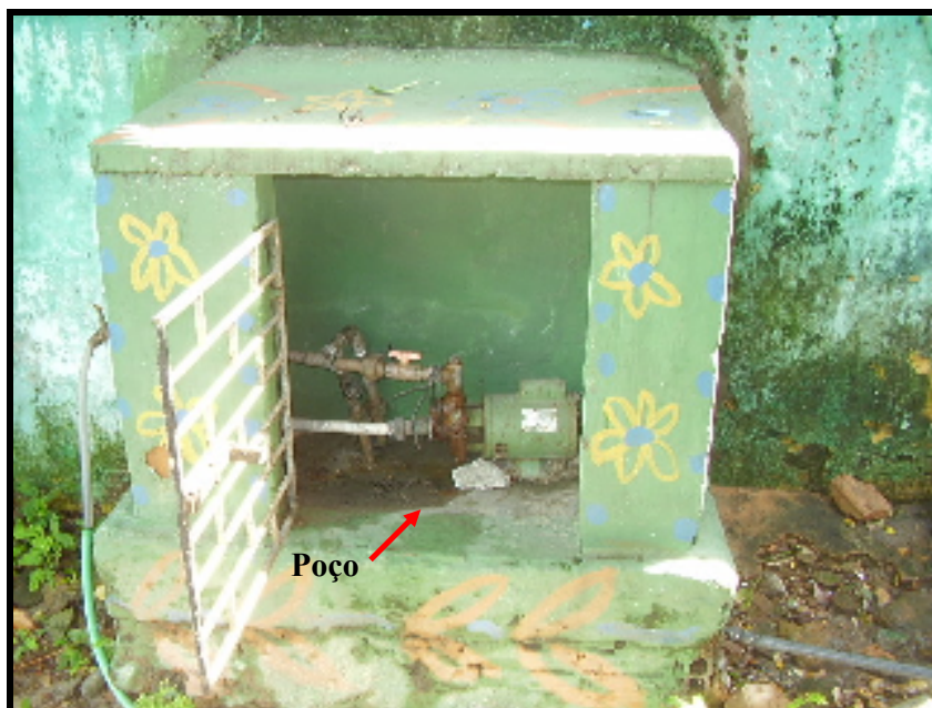
Foto 02 – Poço tubular mediano profundo localizado no bairro Cristo Redentor, Fortaleza/CE. (Novembro/2007)
