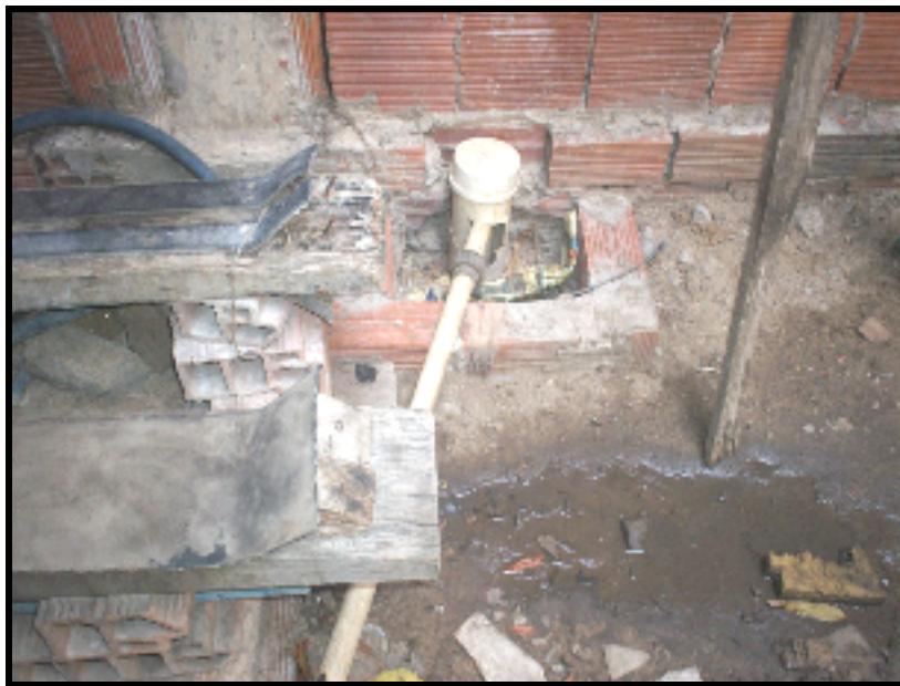
Foto 01 – Poço tubular raso (PTR) localizado no bairro Vicente Pizon, Fortaleza/CE. (Novembro/2007)
