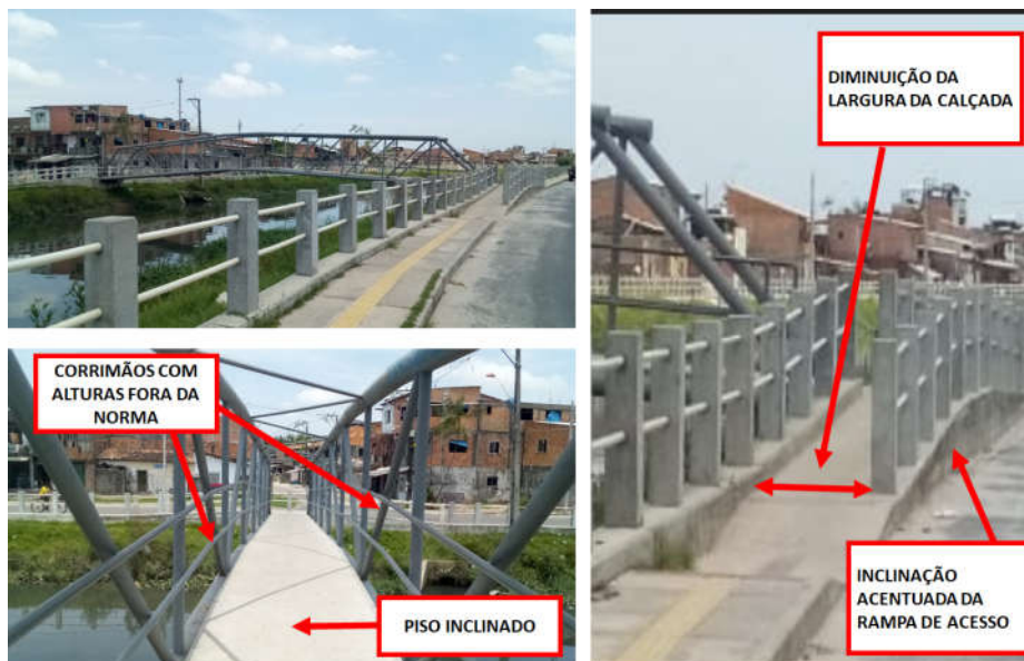
Figura 54. Vistas da ponte e problemas encontrados
