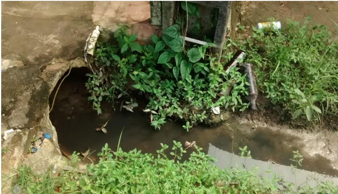
Figura 10: Esgoto doméstico lançado diretamente na rua
