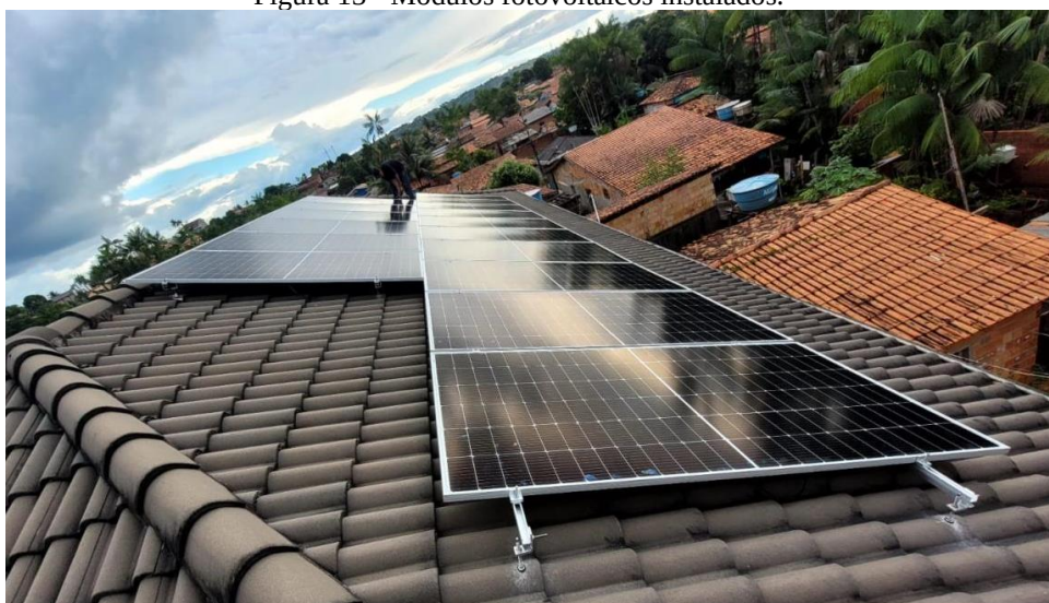
Figura 13 - Módulos fotovoltaicos instalados.
