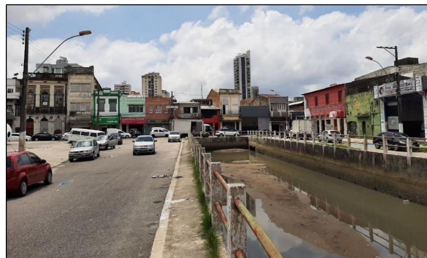
Figura 40 - Parte do canal da Av. General Magalhães, onde é possível perceber o acúmulo de areia ao fundo. Fonte: Davi Santos, 2019.
