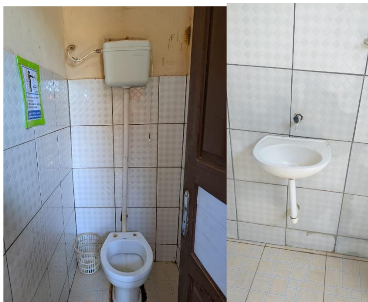
Figura 2. Imagens representativas das condições de infraestrutura e higiênico-sanitárias dos banheiros das escolas.
