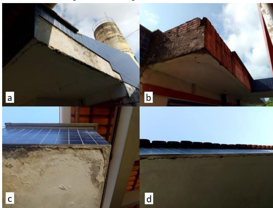
Figura 22 – Dano registrados no edifício
