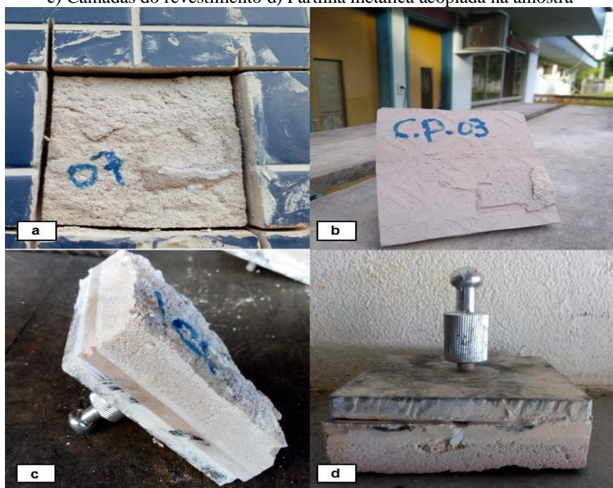
Figura 24 – a) Ruptura parcial no emboço b) Ruptura parcial na argamassa colante c) Camadas do revestimento d) Partilha metálica acoplada na amostra
