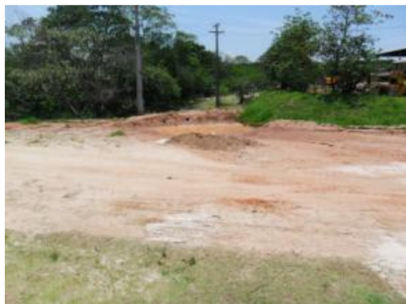
Foto 5.6-2 - Bacia de decantação de água dos acessos internos.
