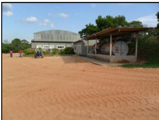
Foto 5.3.2-1 - Tanques de combustível
