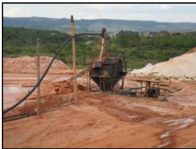
Foto 5.3.1-4 - Primeiro Hidrociclone e silo de deslamagem.
