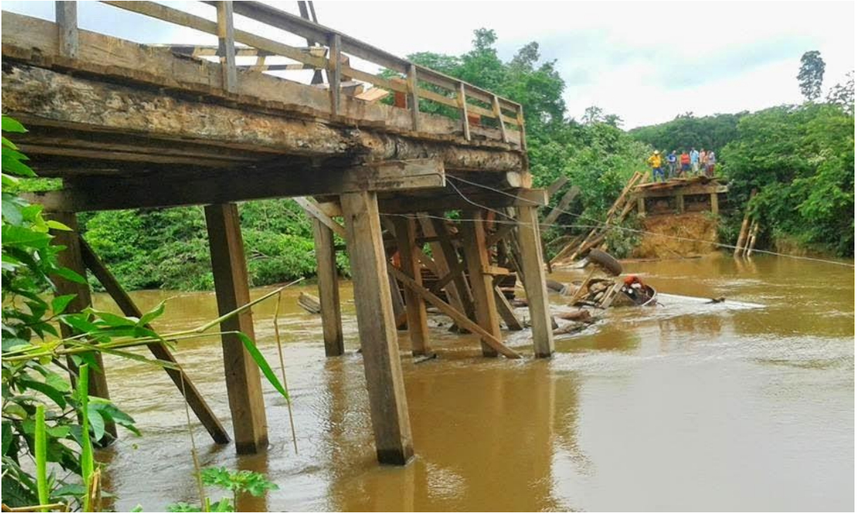
Figura 1 (antes). Quando caiu a ponte do rio Uruará do km 165 sul. Foto obtida por via internet.
