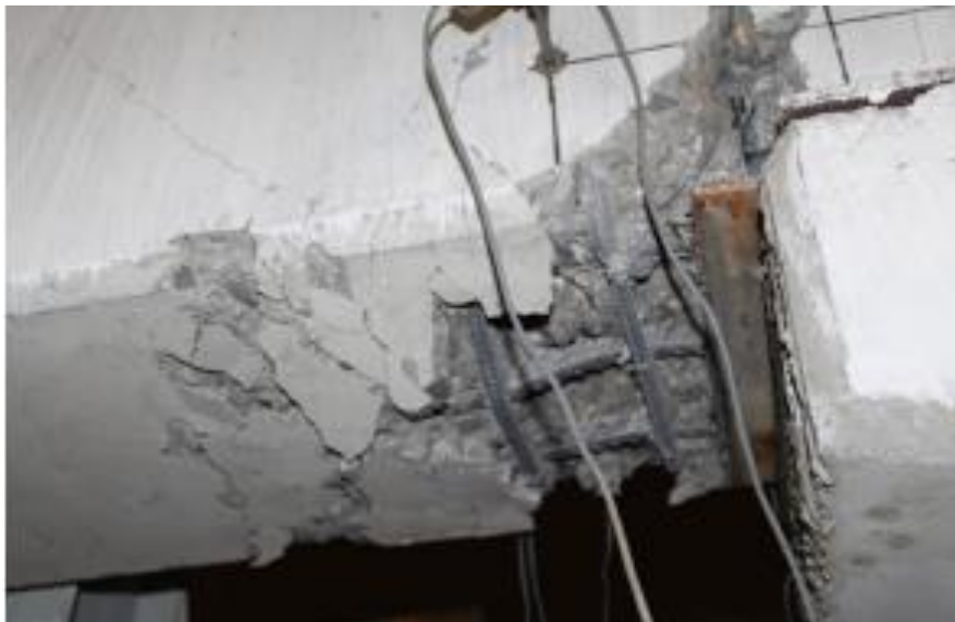
Figura 9 - Ruptura em ligação viga-pilar devido a rotação
