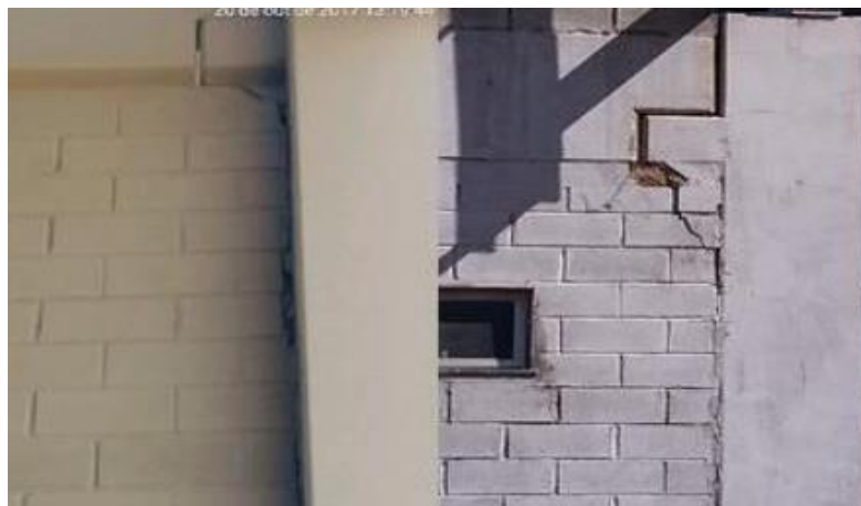
Figura 5 - Fissuração em torno de Pilar Pré-moldado
