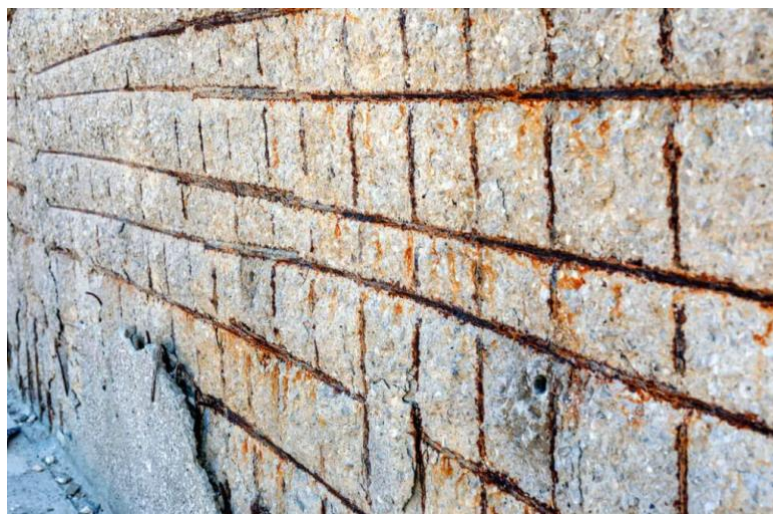
Figura 6 - Carbonatação em armaduras de concreto
