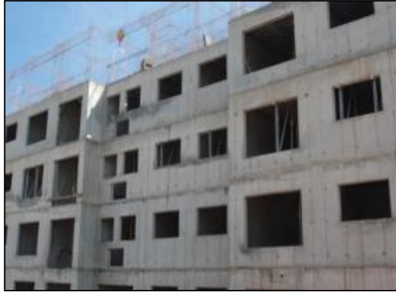
Fotografia 2.6 – Aspecto superficial de paredes de concreto após desforma.
