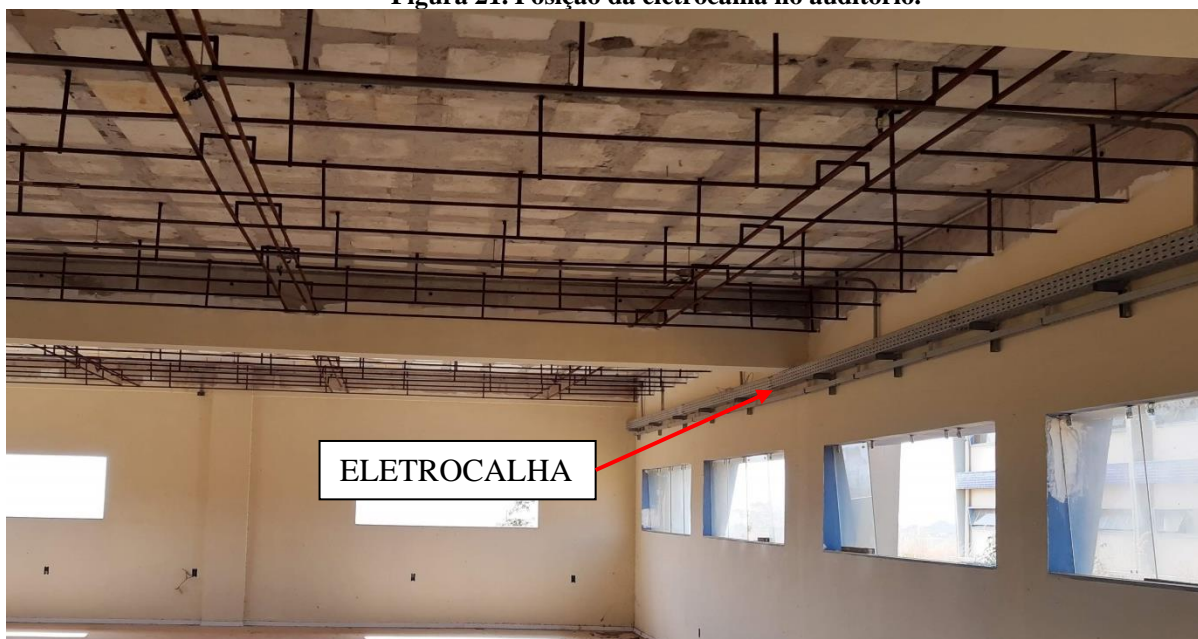
Figura 21. Posição da eletrocalha no auditório.
