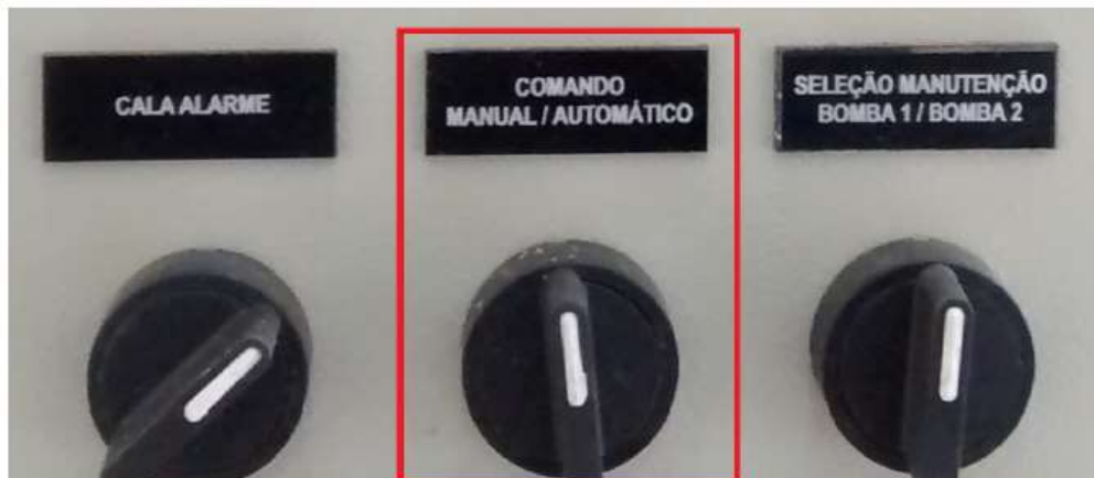
Figura 47 - Chave Seletora para as configurações de "MANUAL/AUTOMÁTICO" do sistema, instalado na porta do "Painel Enterrado".
