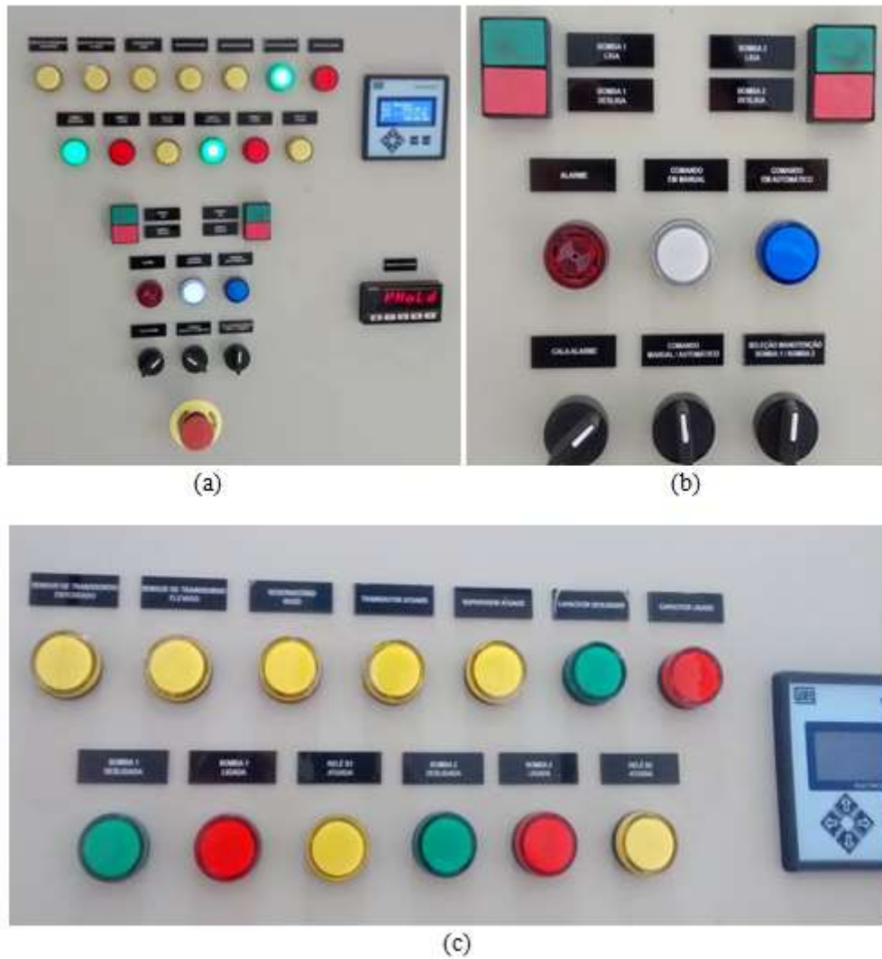
Figura 37 - (a) Porta do Painel de Comando localizado na Estação Elevatório de Água. (b) Enfase nos botões do painel de comando. (c) Enfase nas sinaleiras do painel de comando.
