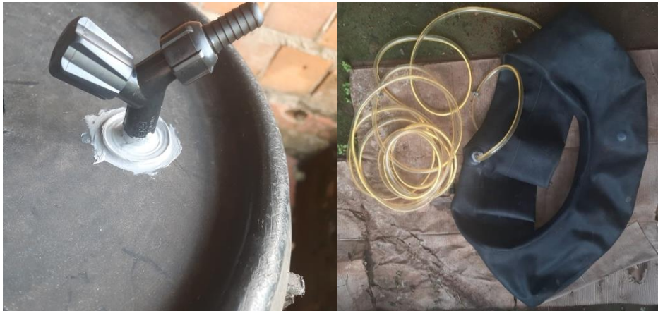
Figura 16 - Saída de biogás e gasômetro externo
