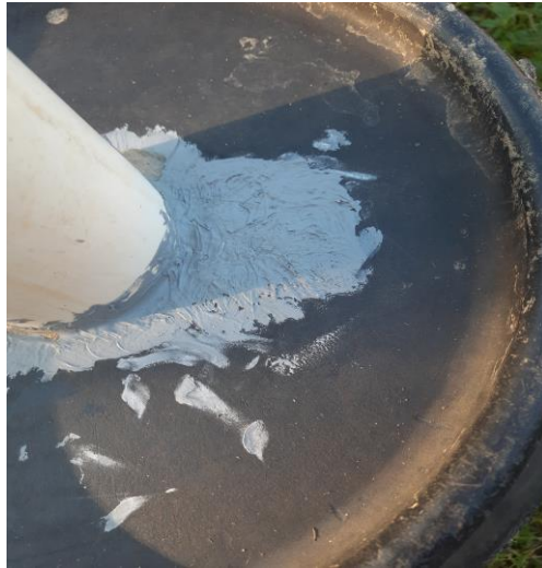
Figura 23 - Vazamento da tampa
