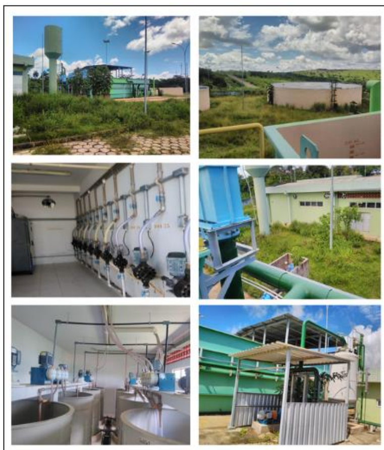
Figura 8 – ETA localizada na vila permanente
