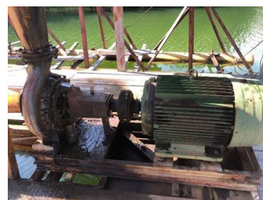
Figura 7 – Bomba de captação
