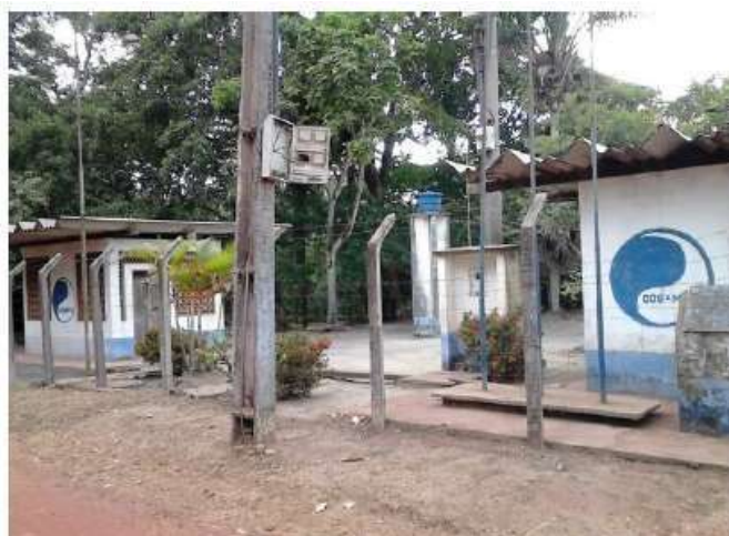
Figura 12- Sistema de captação de água da COSANPA no distrito de Beja. Fonte: (Plano Municipal de Saneamento do Município de Abaetetuba 2017).
