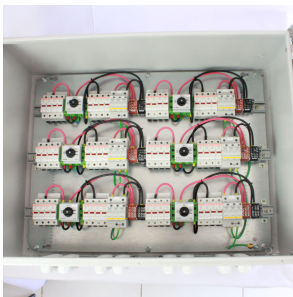
Figura 13 – String box ou caixa de junção
