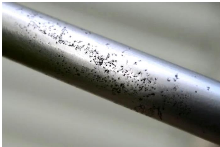
Figura 6 – Corrosão Puntiforme ou Pite
