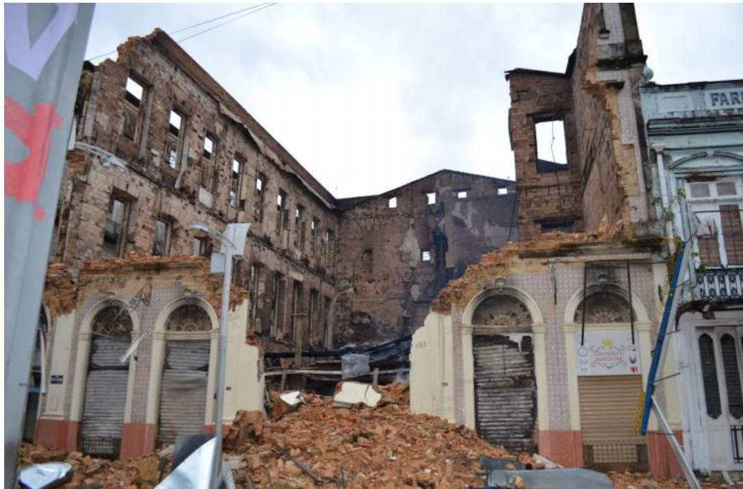
Figura 41: Casa Carvalhaes durante a coleta dos escombros.
