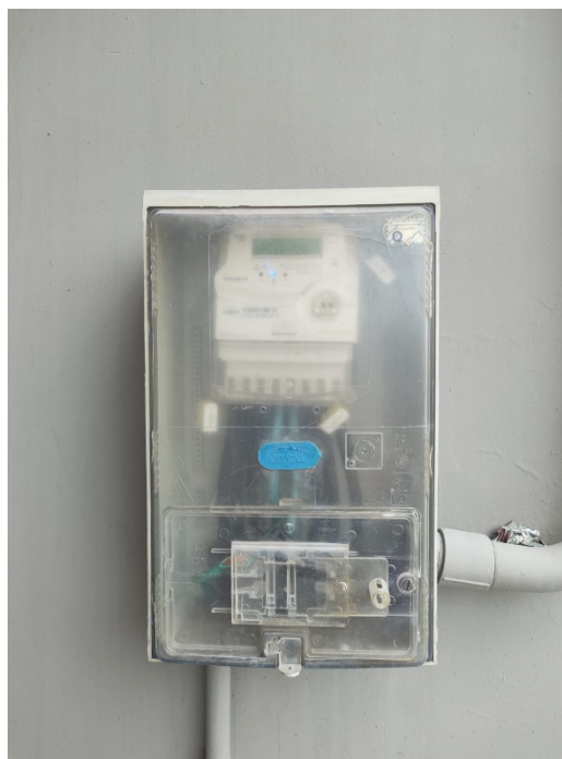
Figura 17 – Padrão de entrada instalado.
