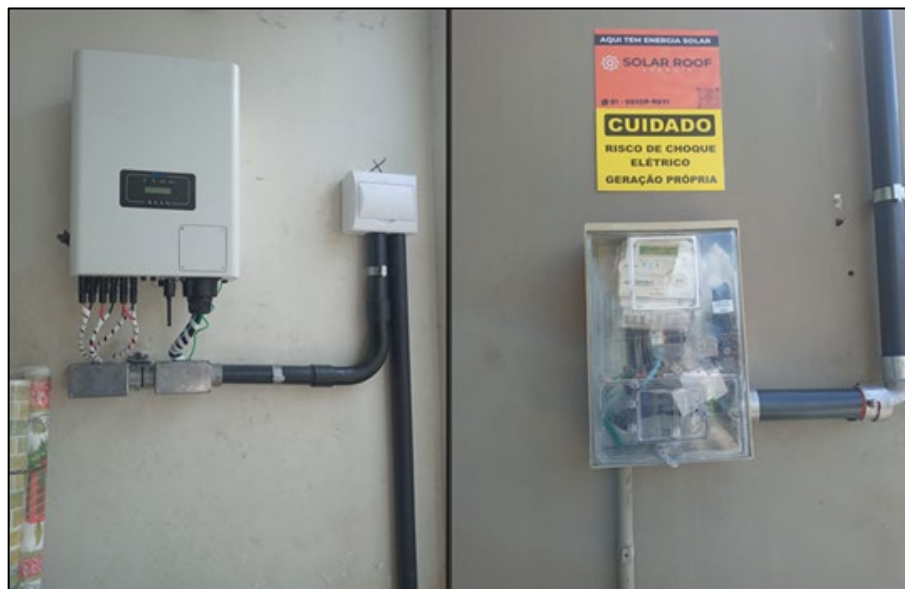
Figura 25 – Inversor e padrão de entrada instalados.
