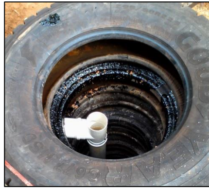
Figura 54 – Tanque de entrada de efluentes.
