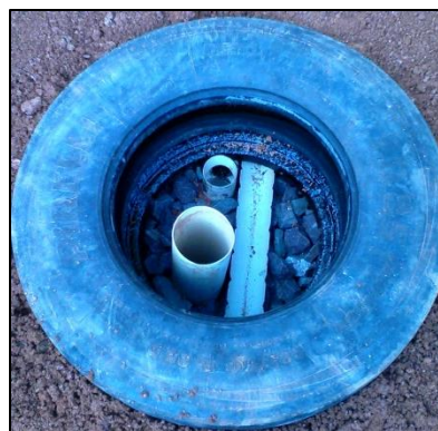
Figura 51 – Leito filtrante do FAN
