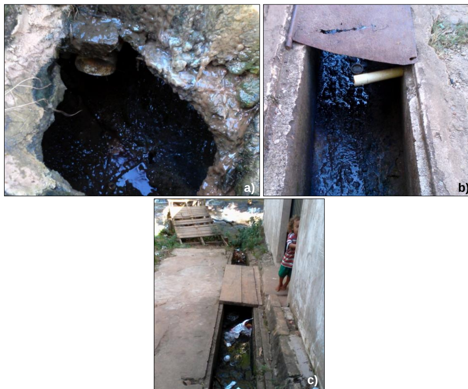
Figura 2 – Lançamento de esgotos na rede de drenagem.
