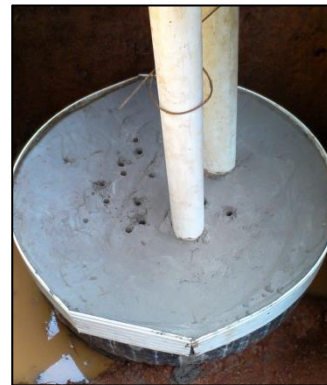
Figura 48 – Concreto não hidratado.
