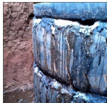
Figura 42 – Desagregação nas juntas entre os pneumáticos.
