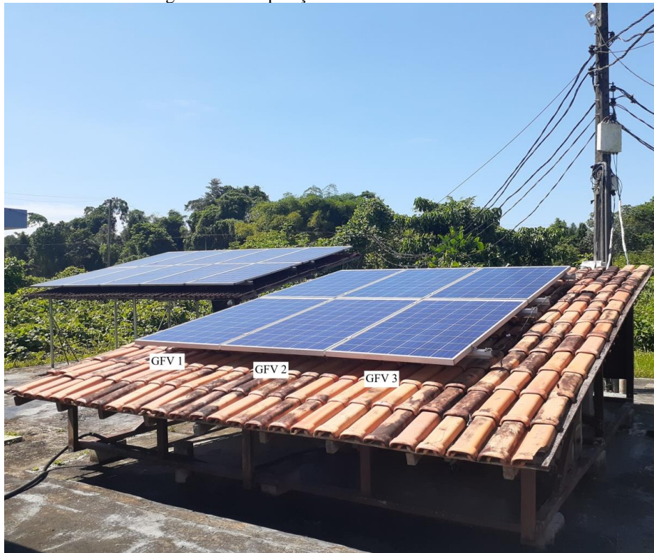
Figura 2.4 - Disposição de cada GFV no telhado.
