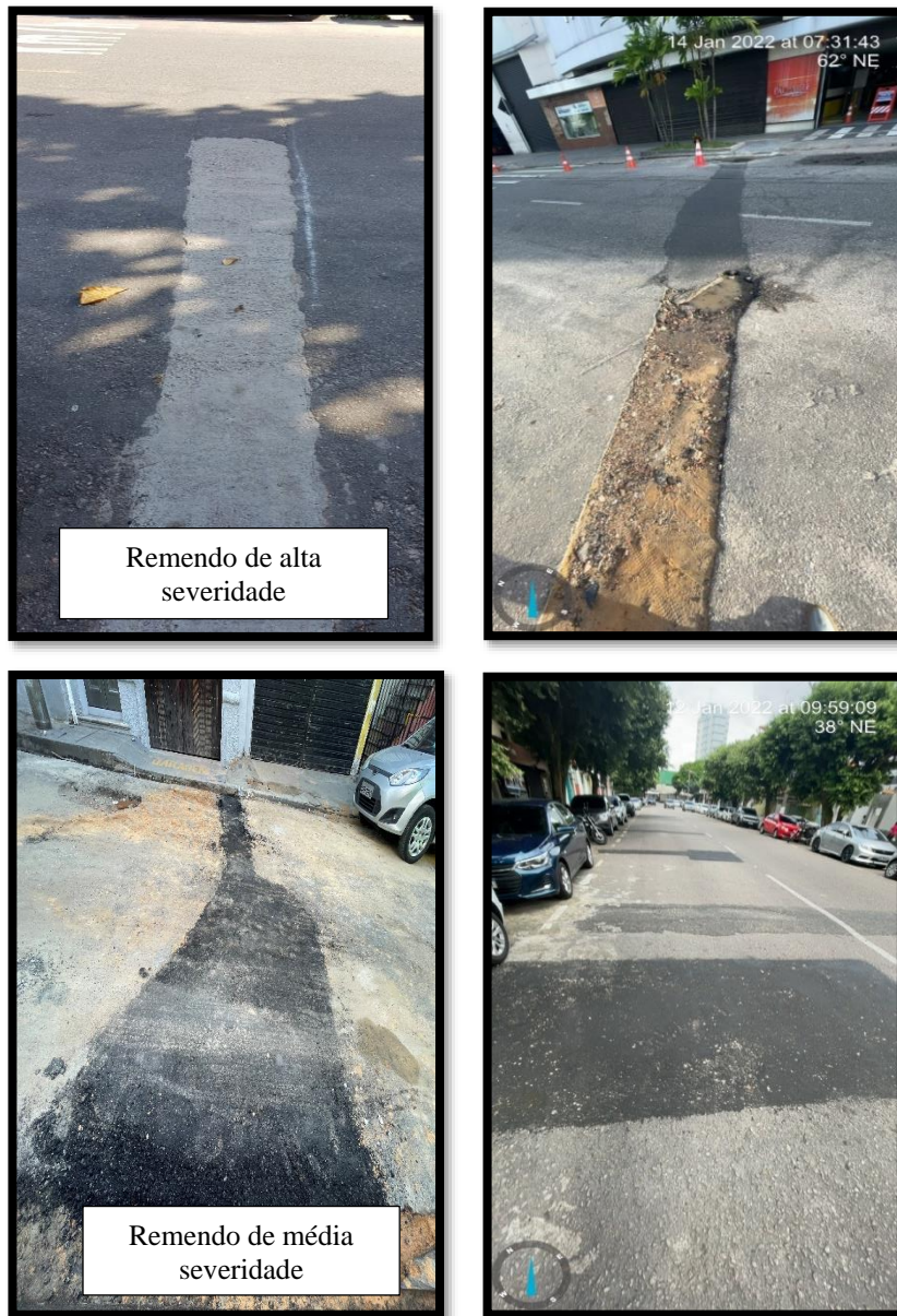
Figura 29 - Remendos de Média e Alta Severidade
