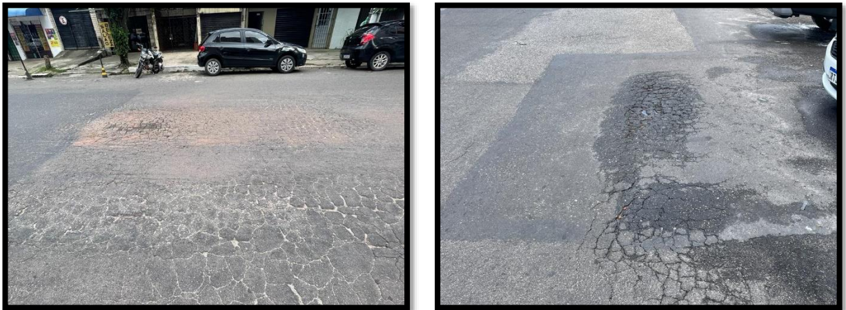
Figura 30 - Trincas por Fadiga
