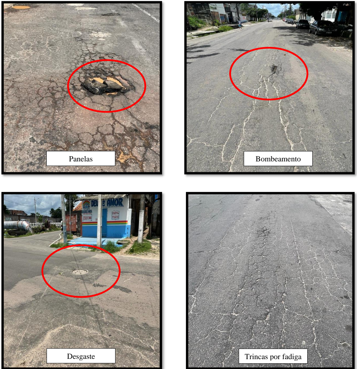
Figura 26 - Defeitos localizados no trecho crítico do bairro de Batista Campos (C38)
