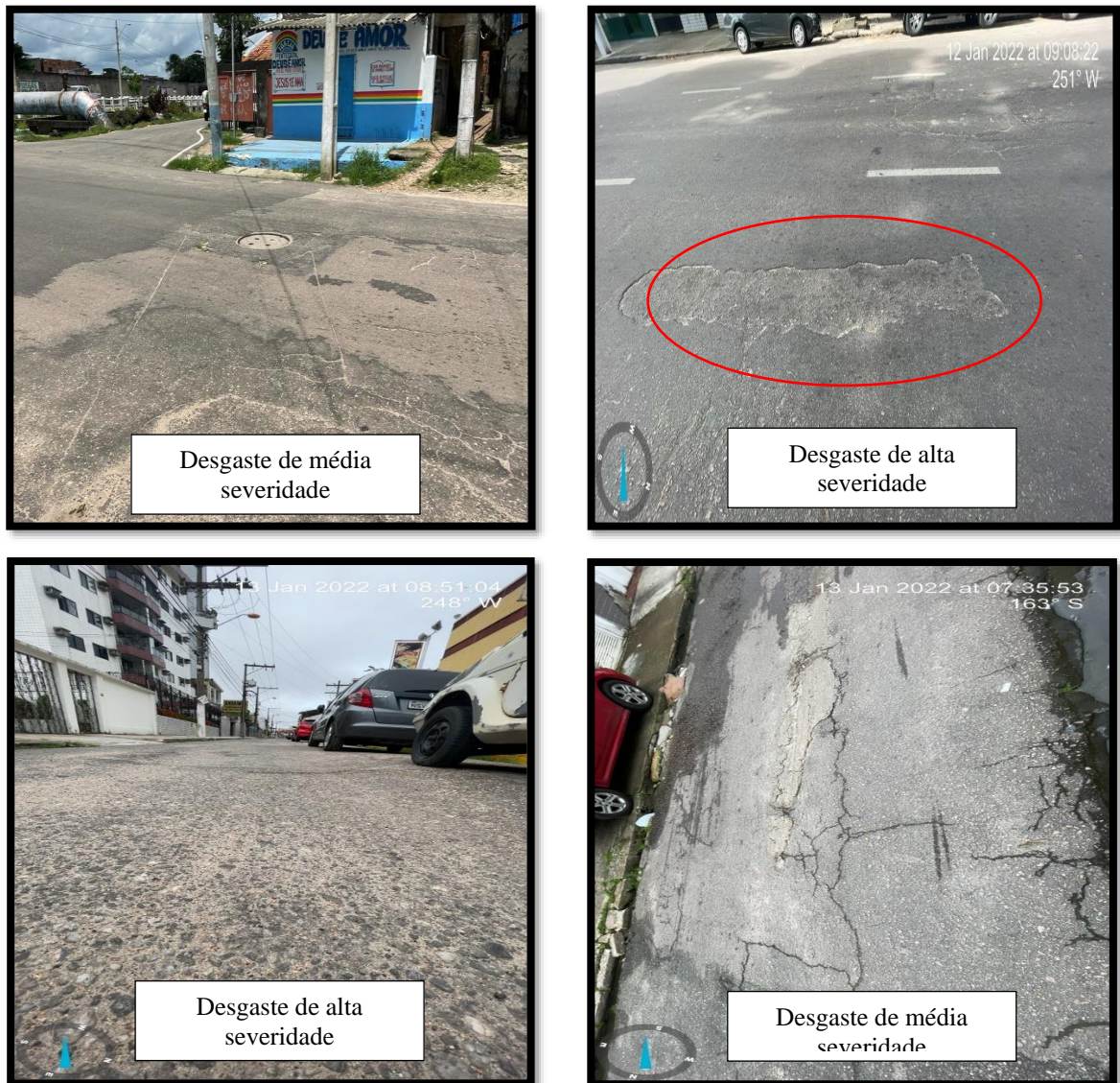
Figura 28 - Desgastes de Média e Alta Severidades
