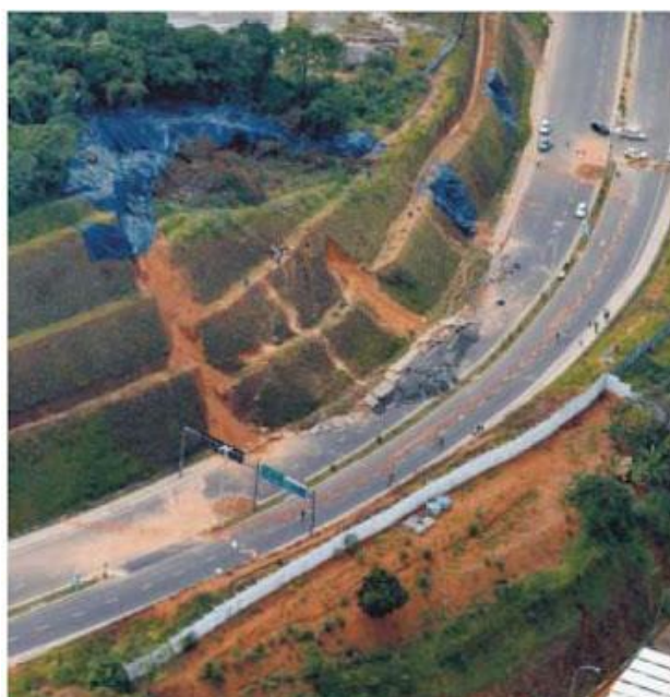
Figura 14 – escorregamento de talude de corte na Av Luis Eduardo Magalhães e uso de lonas plásticas para conter erosão. Fonte: www.cprm.gov.br .
