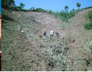
Fig 10 – mesma área após deslizamentos. Ano: 2008. Fonte: www.vetiver.org .
