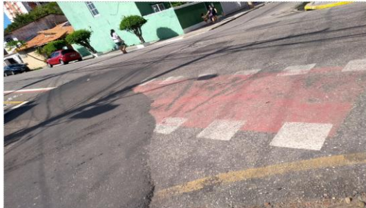
Figura 45: Falha na demarcação no início do trecho 02
