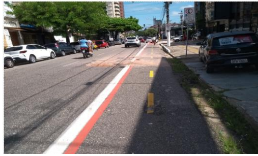
Figura 39: Buraco na faixa de rodagem
