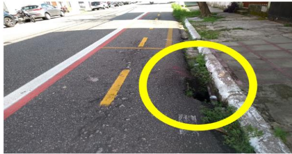
Figura 36: Bueiro sem a grelha de proteção
