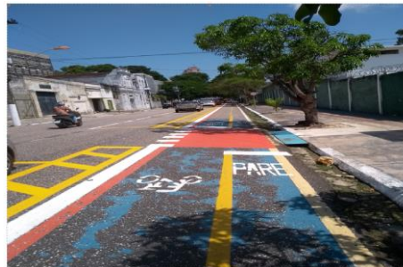
Figura 48: Sinalização sobreposta e desgastada no trecho 04
