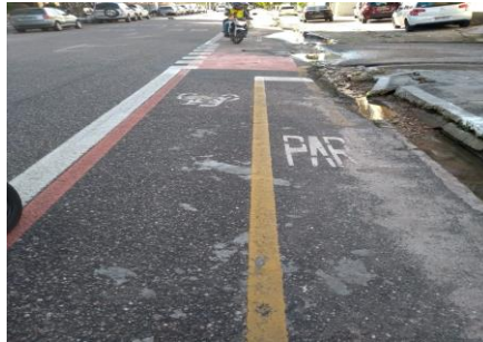
Figura 47: Sinalização sobreposta no trecho 03
