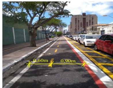
Figura 32: Espaço útil irregular entre as faixas no trecho 4
