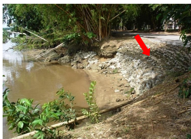
Figura 31 - Medidas paliativas de contenção, sacas de areia e cimento.
