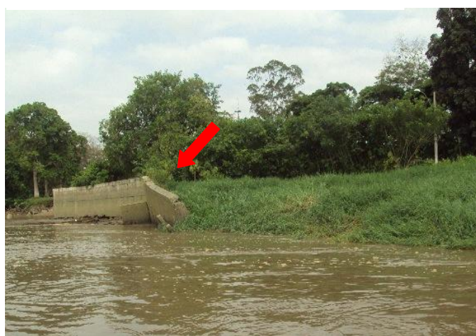
Figura 30 - Muro de arrimo vertical tombado.
