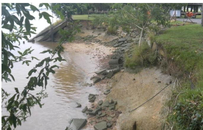
Figura 25 - Ponto de erosão com 33,5 metros de extensão
