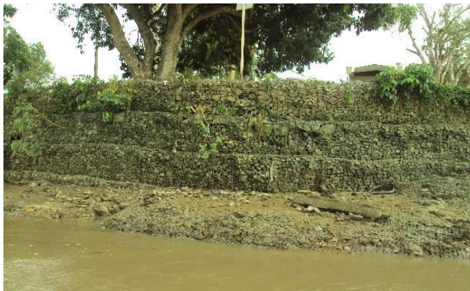
Figura 265 - Contenção em gabião do tipo caixa.
