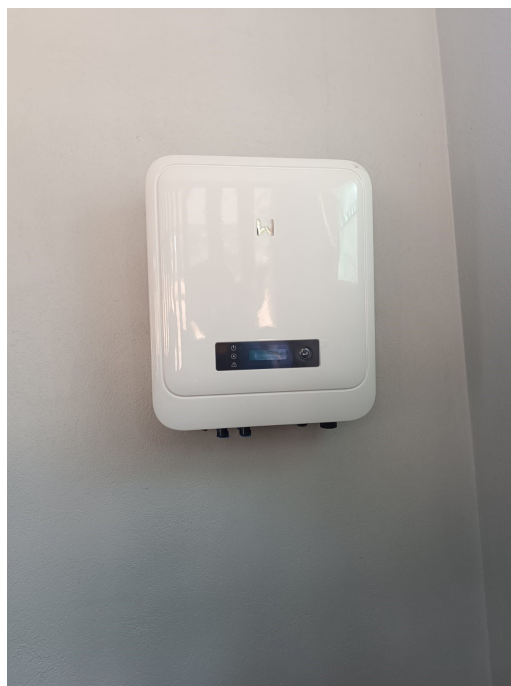
Figura 5 – Inversor fotovoltaico Goodwe
