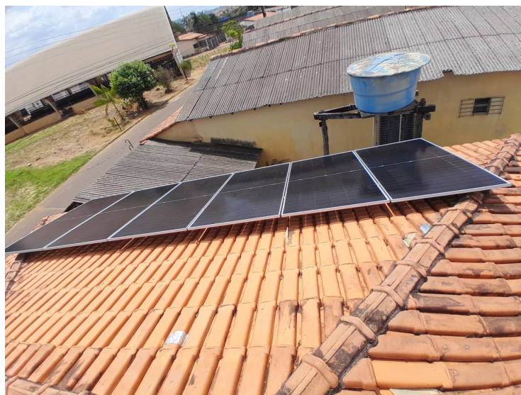
Figura 10 – Módulos instalados inclinação sul
