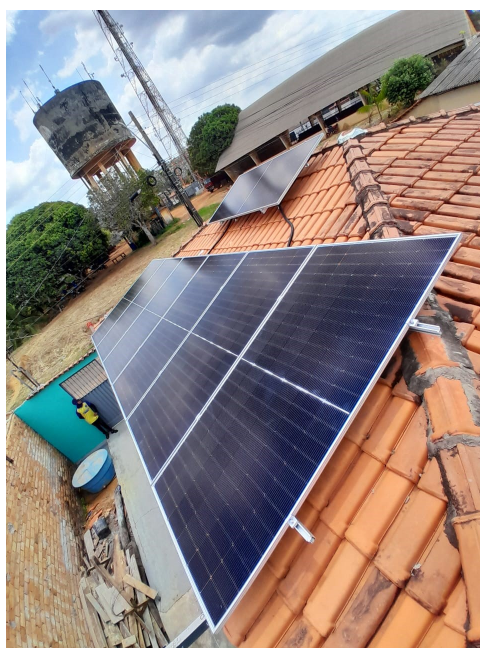
Figura 9 – Módulos instalados inclinação norte
