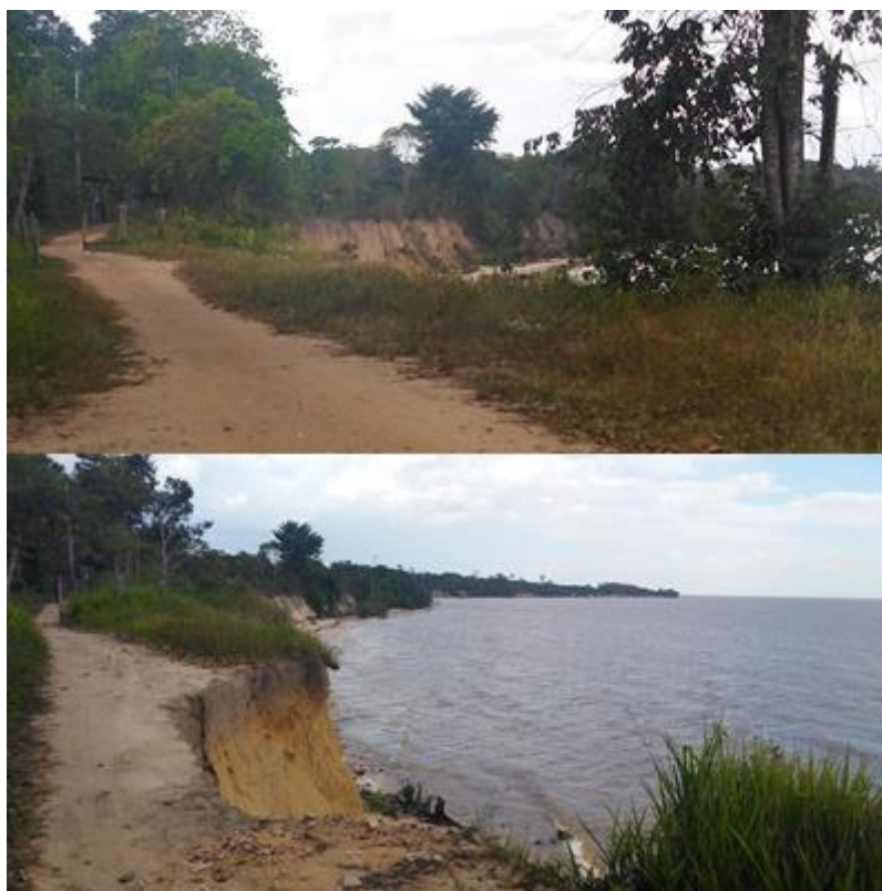
Figura 24 - Erosão na estrada de acesso à praia Pedra Branca em Cotijuba, Pará
