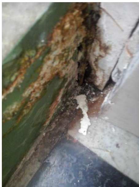
Fig.22- Manchas observadas na Janela 1 do Salão Verde. Fonte: Acervo Pessoal.
