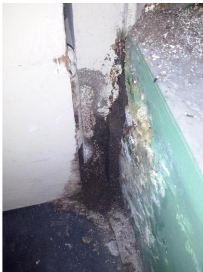
Fig.20- Incidência de insetos xilófagos na primeira janela do Salão Verde. Registro feito no último dia de coleta/medição. Fonte: Acervo Pessoal.
