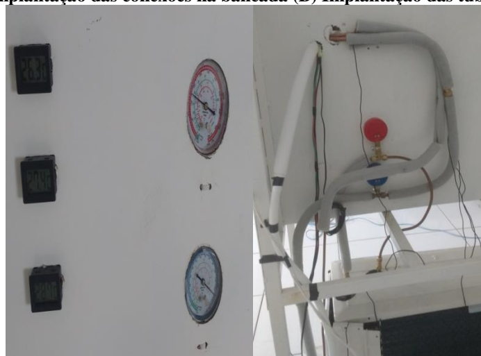
Figura 33. (A) Implantação das conexões na bancada (B) Implantação das tubulações de cobre.
