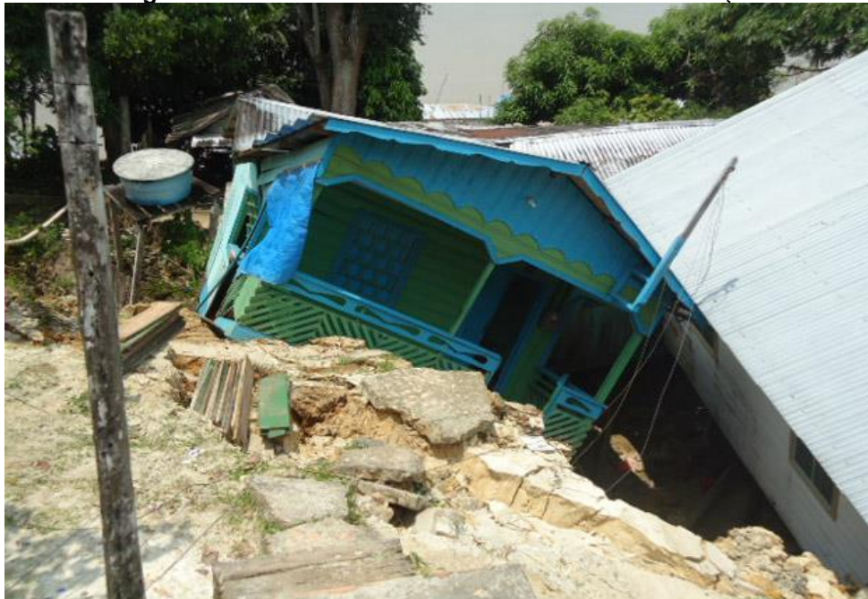
Figura 2: Deslizamento de terra em São Paulo de Olivença.
