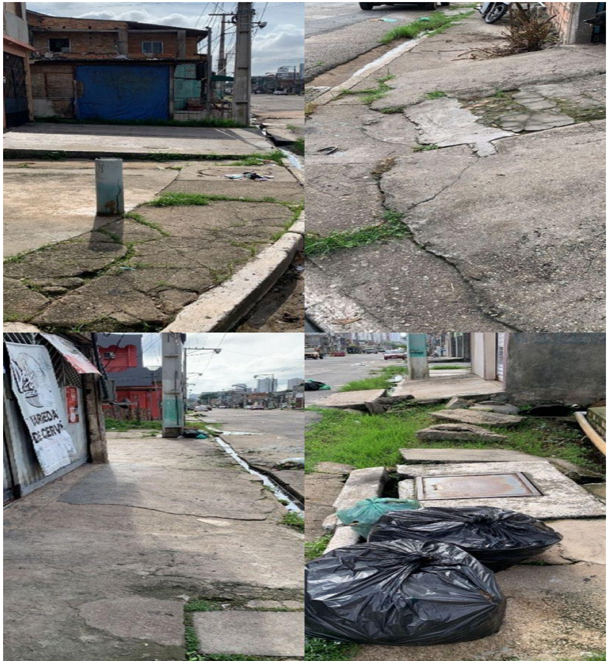
Figura 1: Fotos das calçadas do trecho 1 (entre Rua Canal do Galo e Rua Nova)
