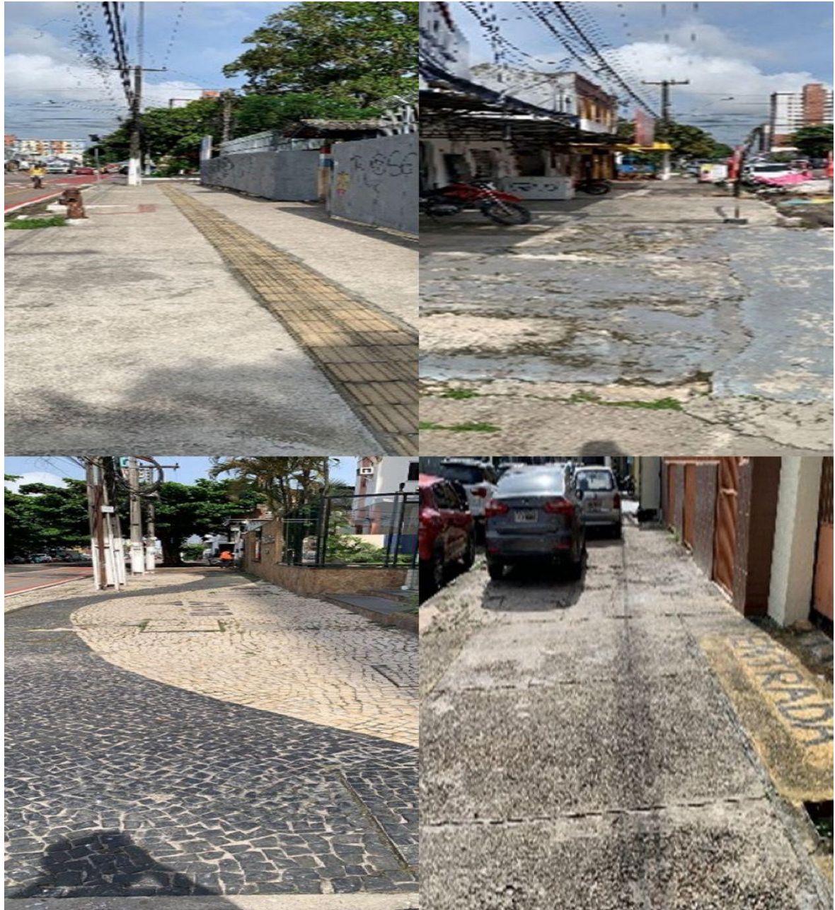
Figura 4: Fotos das calçadas do trecho 4 (entre Av. Pedro Miranda e Av. Marques de Herval)
