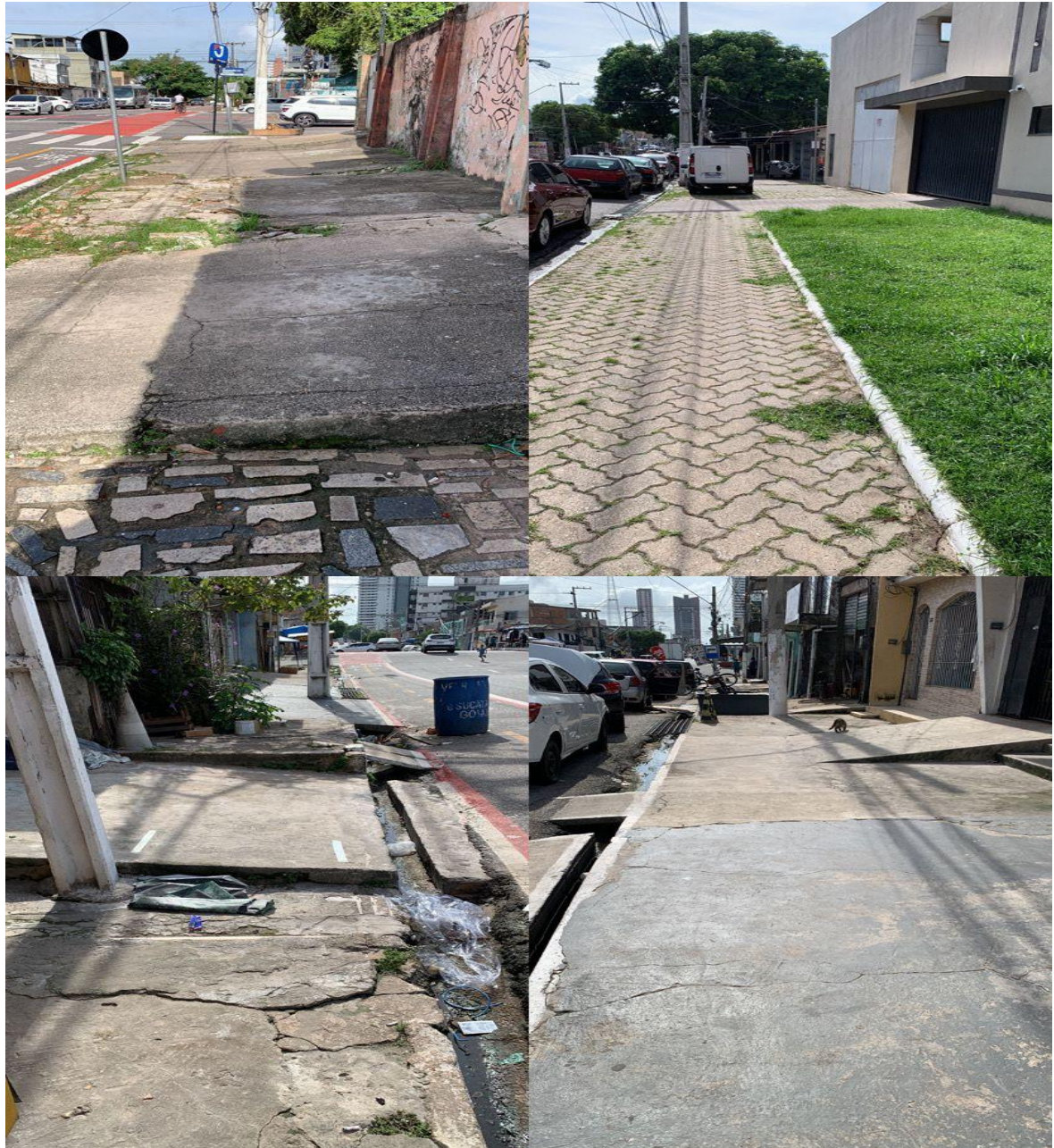
Figura 5: Fotos das calçadas do trecho 5 (entre Av. Marques de Herval e Av. Visconde de Inhaúma)
