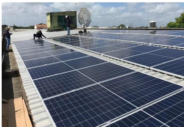
Figura 24 - Disposição dos módulos fotovoltaicos
