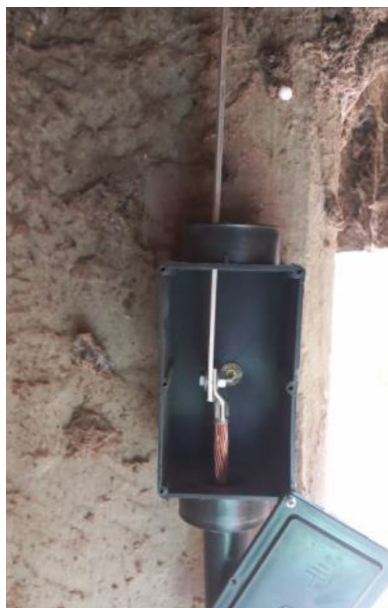
Figura 22 – Caixa de inspeção suspensa - barracão de resíduos
