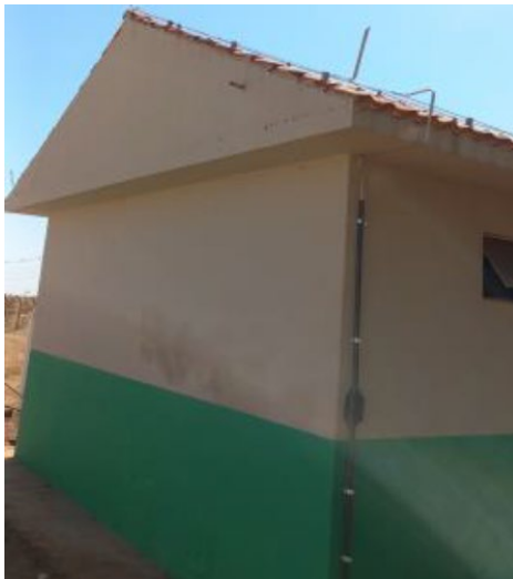
Figura 18 – Captores não-naturais instalados - banheiro motoristas
