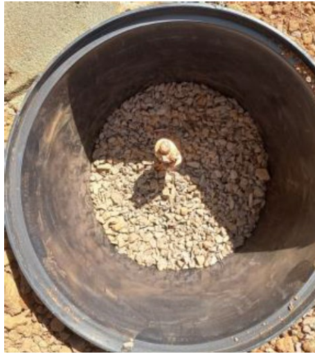
Figura 16 – Caixa de inspeção no solo - banheiro motoristas
