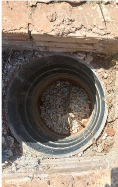
Figura 26 - Caixa de inspeção no solo - armazém
