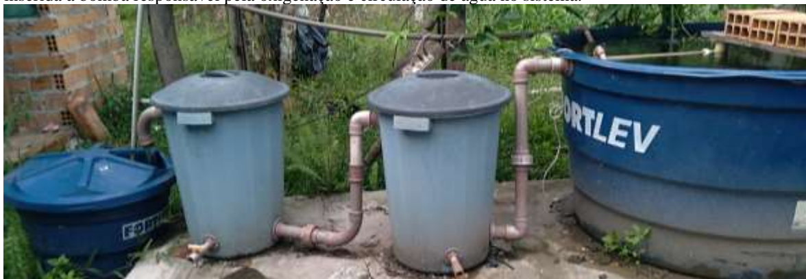
Figura 10-Adaptação feita no sistema aquapônico: inserção de uma caixa d'água de 100 litros onde foi inserida a bomba responsável pela oxigenação e circulação de água no sistema.
