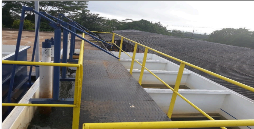
Figura 11 – Câmaras de Filtração da ETA – Vila.
