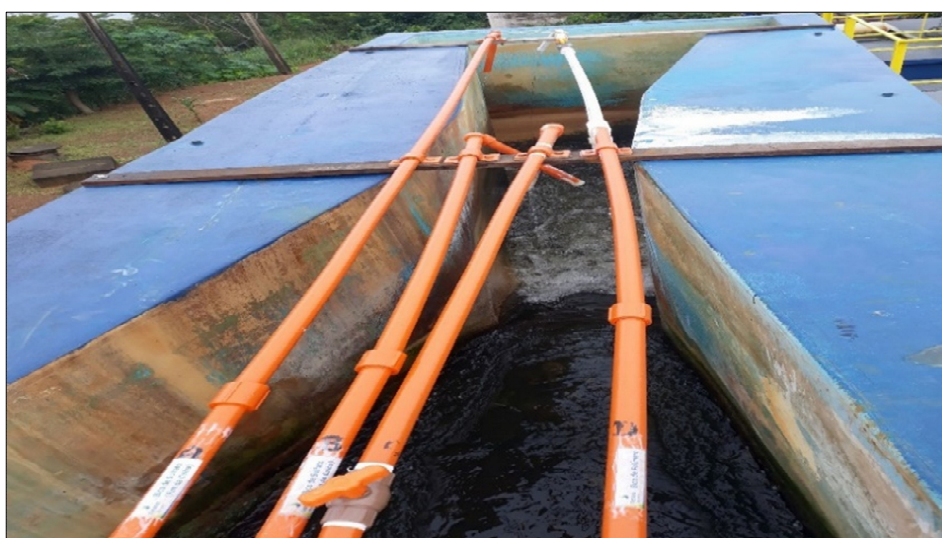
Figura 7 – Calha Parshall da ETA – Vila.
