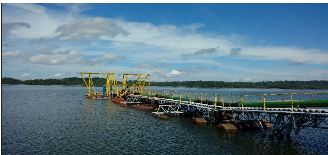
Figura 6 – Ponto de Captação da ETA – Vila.
