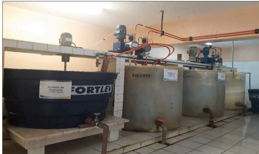
Figura 8 – Sistema de Dosagem de Produto Químico.
