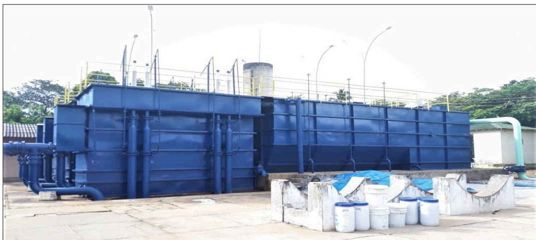
Figura 5 – Estação de Tratamento de Água da Vila Permanente – Tucuruí.
