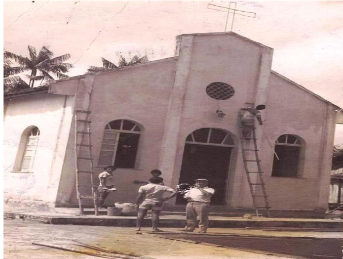
Figura 10: Reforma da primeira igreja construída na comunidade de São Miguel de Murutinga.
