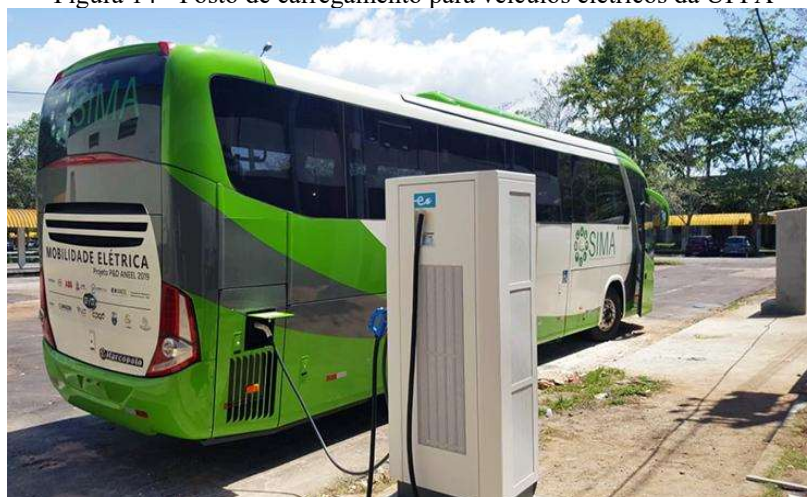
Figura 14 - Posto de carregamento para veículos elétricos da UFPA
