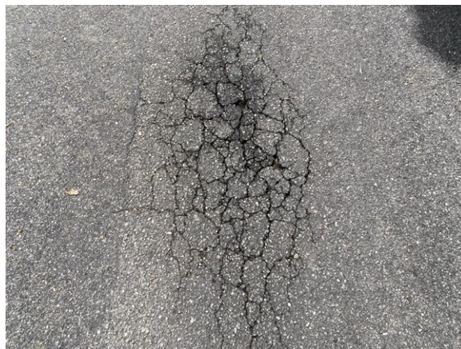
Figura 6 – Trinca por Fadiga.
