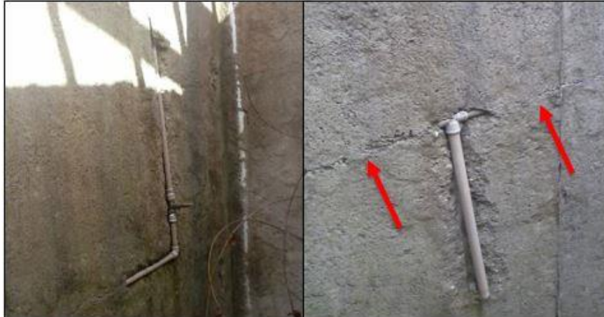
Figura 40 - Tubulação de água fria exposta apresentando fissuras paralelas à tubulação (à direita).
