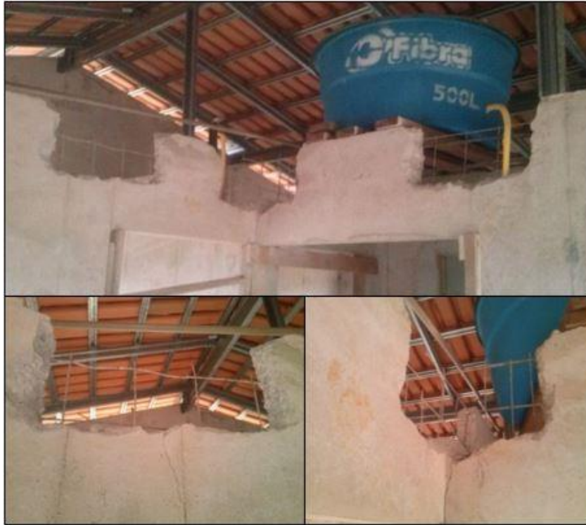
Figura 34 - Aberturas nos vãos centrais com ausência de armadura de reforço.
