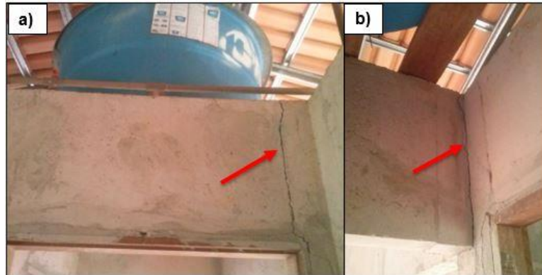
Figura 24 - a) trinca vertical localizada na parede entre o quarto e circulação; b) trinca vertical abaixo da estrutura da caixa d'agua.
