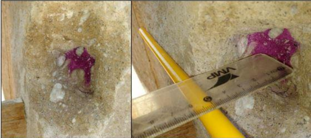
Figura 22 – Frente de carbonatação medindo 5 cm.
