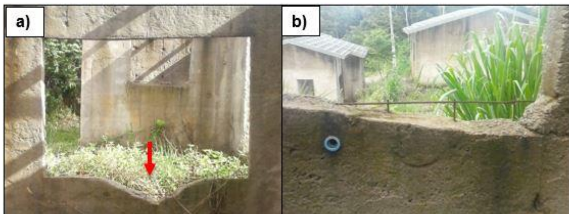
Figura 31 - a) falha de concretagem abaixo da janela do quarto; b) falha abaixo da janela da cozinha.
