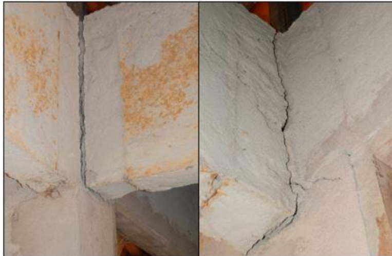
Figura 25 - rachaduras localizadas na parede da circulação vista por diferentes ângulos.
