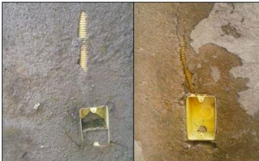
Figura 38 - Eletrodutos expostos devido a erros no processo executivo.
