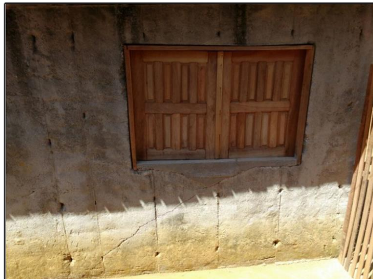
Figura 21 - Parede com juntas de concretagem, fissura e perfurações no concreto.
