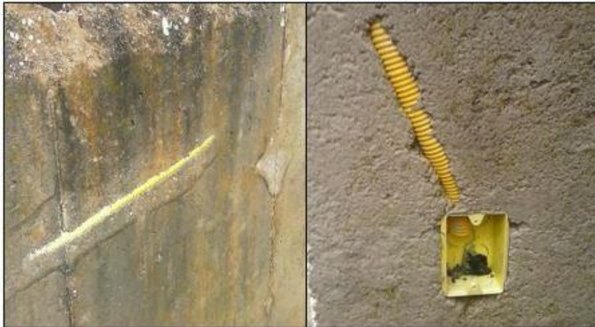
Figura 39 - Eletrodutos expostos nas paredes.
