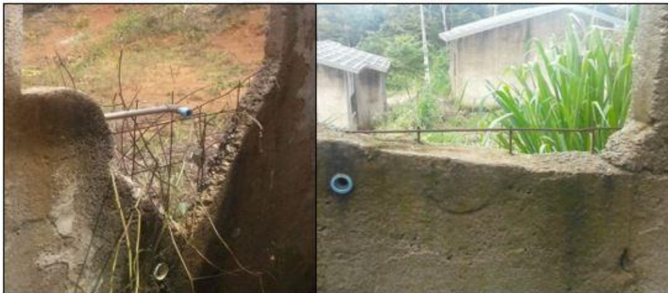
Figura 35 - Falha de concretagem em duas residências abaixo das janelas das cozinhas.
