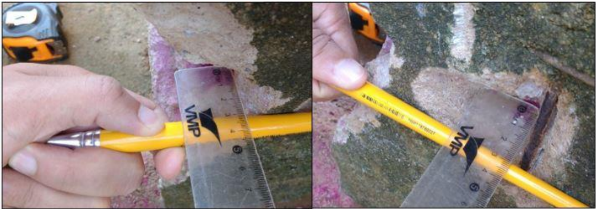
Figura 20 - Mensuração da frente de carbonatação em dois pontos próximos.
