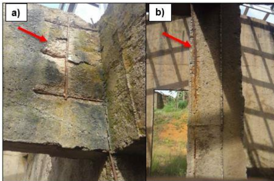
Figura 28 - a) corrosão avançada na armadura e deslocamento do concreto; b) armadura exposta e com cobrimento insuficiente sofrendo corrosão.
