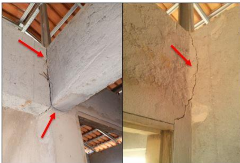
Figura 26 - rachaduras na junção das paredes dos vãos centrais.
