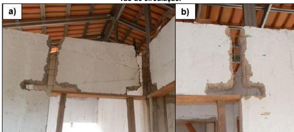
Figura 33 - a) Abertura no vão da parede entre a sala e cozinha da residência; b) abertura na parede do vão de circulação.
