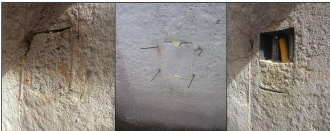
Figura 42 - Quadros de distribuição e caixa de passagem preenchidos com concreto.
