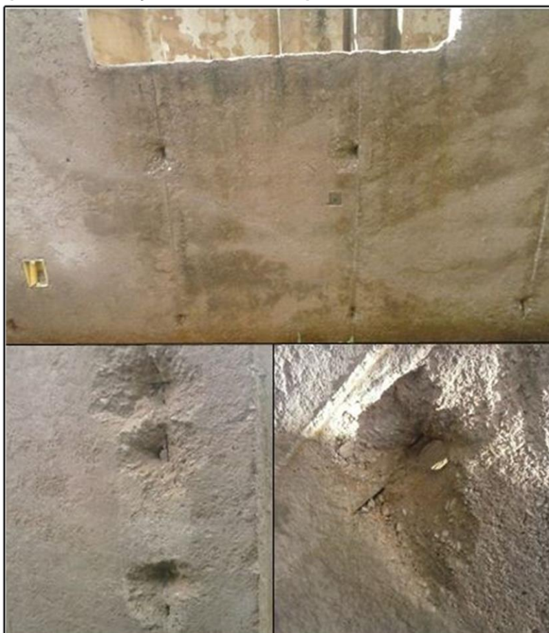
Figura 36 - Perfurações nas paredes originadas na desforma inadequada.
