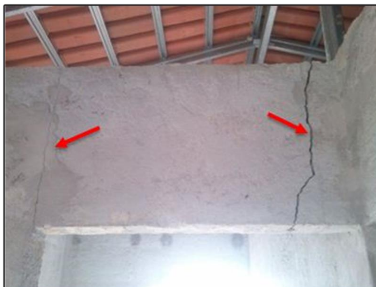
Figura 27 – Indicação de fissura e trinca no vão da parede.
