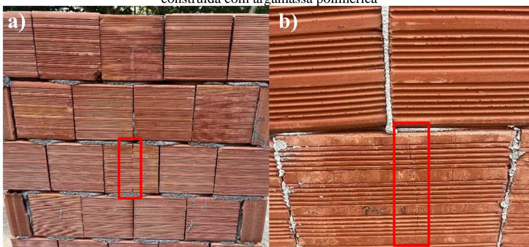
Figura 28 - Fissuras superficiais: a) parede construída com argamassa convencional, b) parede construída com argamassa polimérica
