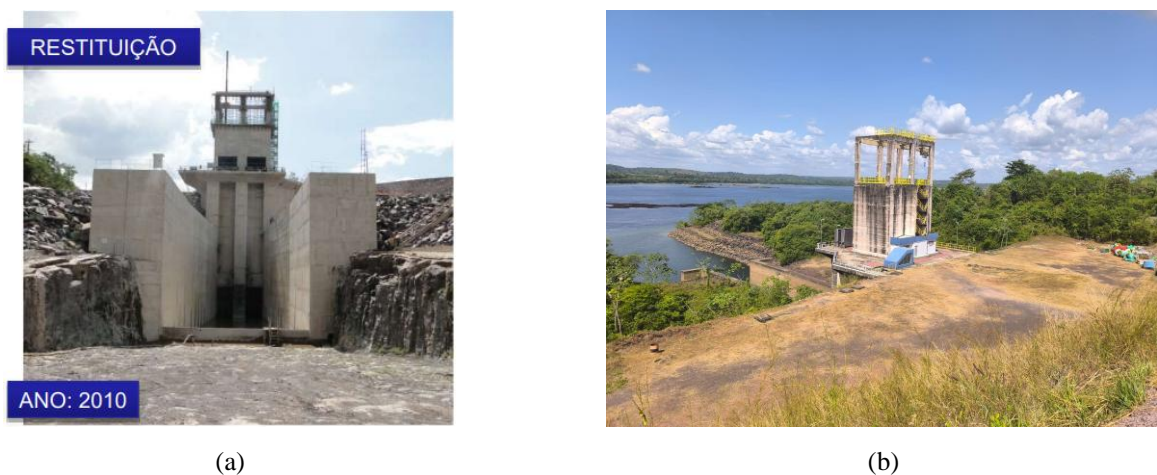
Figura 20 - Estrutura da comporta de esvaziamento da Eclusa 2
