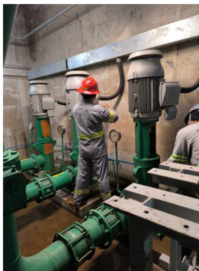
Figura 33 - Inspeções em motores do sistema de drenagem
