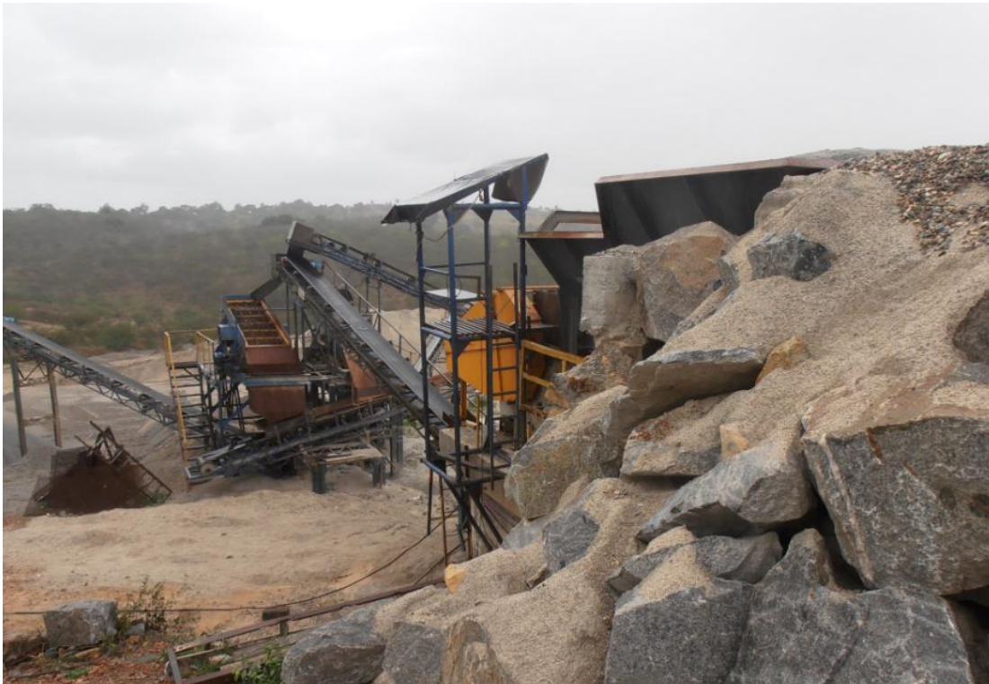
Figura 11. Central de Britagem I (em operação).
