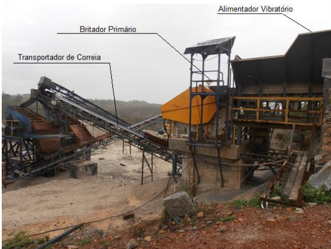
Figura 19. Foto do Transportador de Correia (TC-1), Britador Primário e Alimentador Vibratório.
