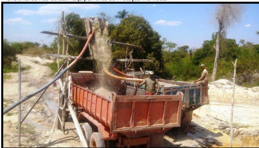
Figura 13 - Caminhão recebendo areia a uma distância aproximadamente de 40 metros da cava para se direcionar ao depósito que encontra a 12 km deste local, ao observar que os funcionários não utilizam Equipamento de Proteção Individual
