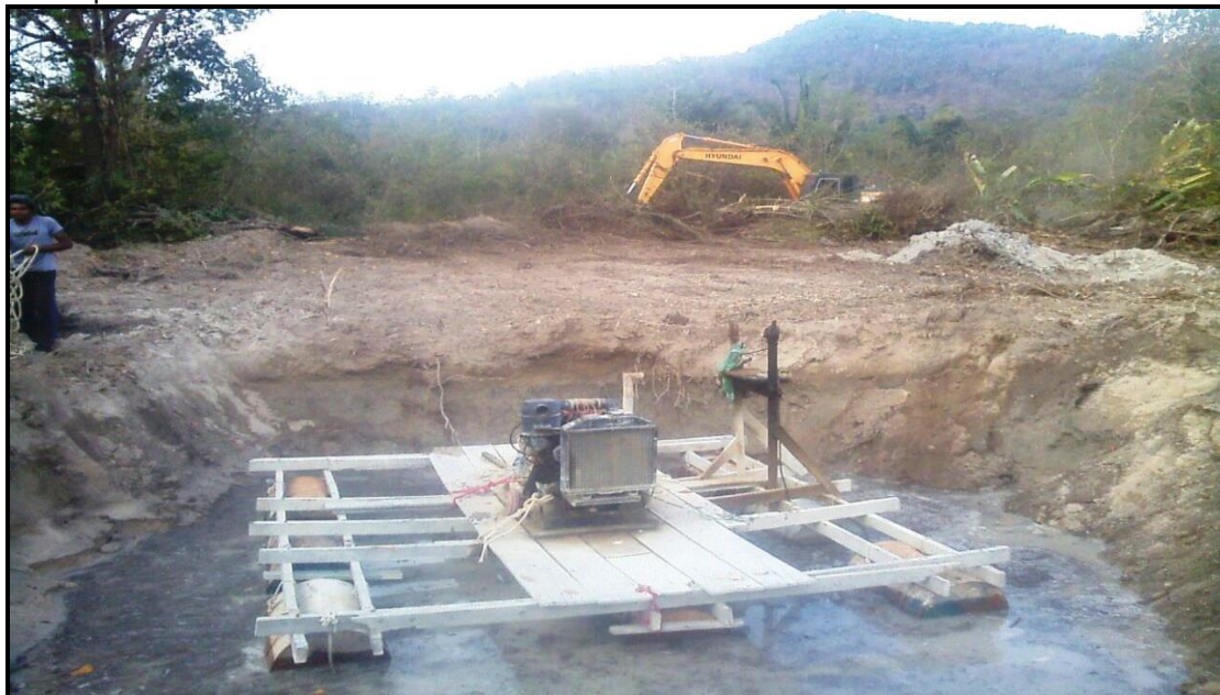
Figura 14 - Extração de areia em cava submersa em Redenção/PA, balsa inadequada para este tipo de atividade
