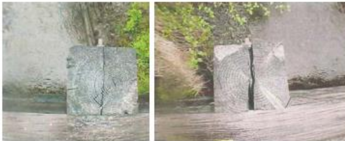
Figura 12 - Fendilhamento em topo de pilarete na linha de parafusos.
